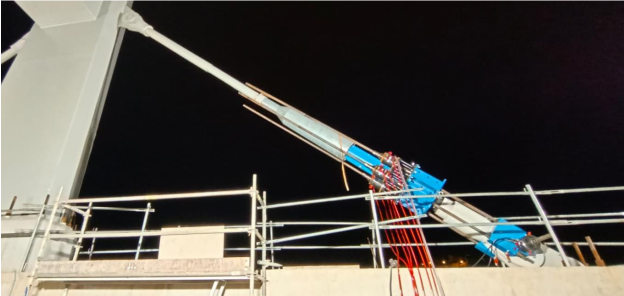
Figura 10. Vista del equipo instalado en un tirante.
