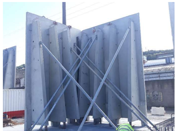
Figura 28. Quiebro 3 del muro interior 2.
