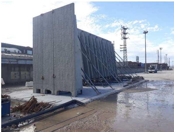
Figura 29. Quiebro 3 del muro interior 2.
