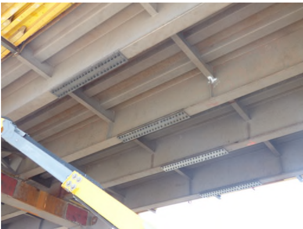
Figura 9. Refuerzo atornillado en alas inferiores.
