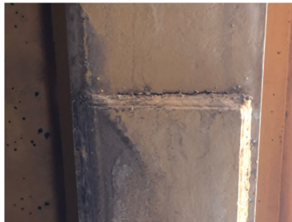
Figura 3. Fotografía de una fisura a fatiga detectada.
