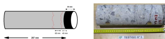
Figura 13. Ejemplo de probeta testigo extraída que confirma la existencia de fisuras en el hormigón
