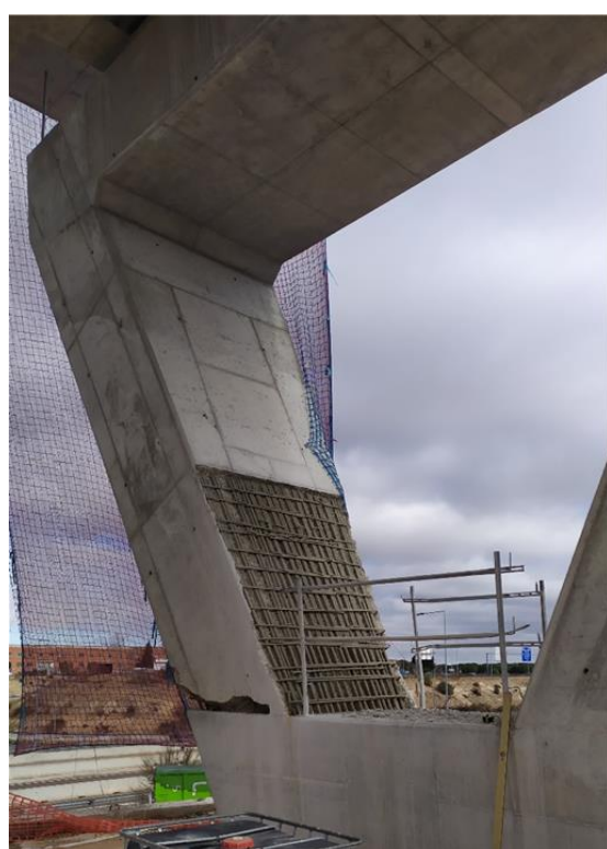
Figura 9. Aspecto general de la pila, brazo de la margen izquierda (con defectos)
