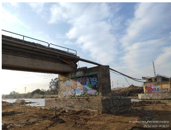
Figura 1. Vano colapsado del puente existente.
