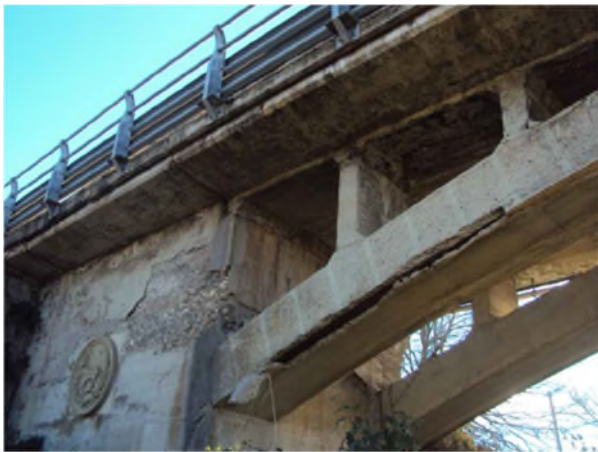
Figura 2. Algunos de los daños detectados en el puente.
