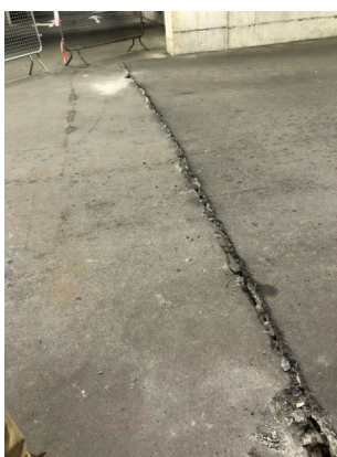
Figura 2. Vista de la fisura detectada
