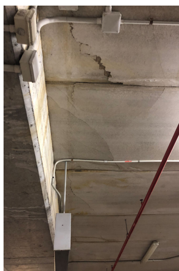
Figura 6. Detalle de zona de localización de la fisura desde la parte inferior del forjado (planta -2)
