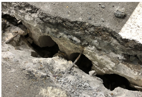
Figura 5. Detalle de cata efectuada en el entorno de la fisura
