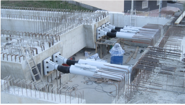
Figura 2. Detalle dispositivos antisísmicos en Viaducto Callosa-Cox
