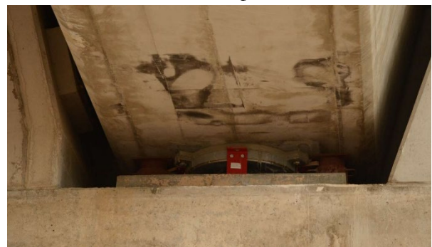
Figura 5. Detalle de dispositivos antisísmicos en Viaducto sobre el Trasvase Tajo-Segura
