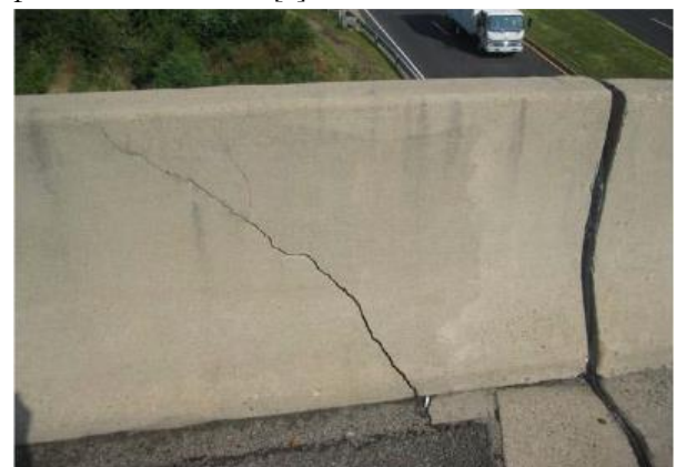
Figura 10. Fisura observada en una barrera montada sobre una “moment slab” [4]
