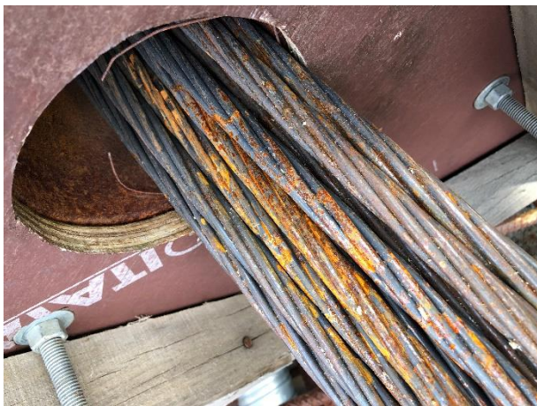
Figura 16. Signos de oxidación en los cordones de pretensado longitudinal situados en las almas del puente.
