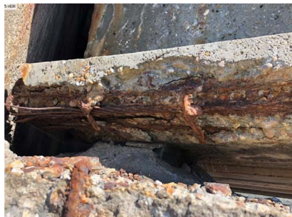
Figura 10. Detalle cables de pretensados afectados por corrosión.
