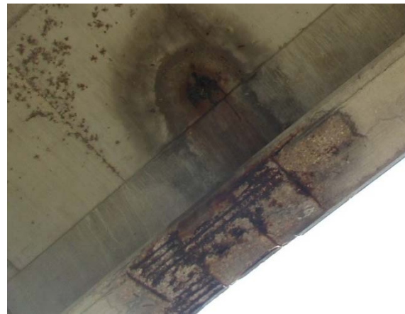
Figura 6. Ausencia de bajante en sumidero de tablero, produciendo la circulación del agua por los paramentos de losa y viga, produciendo graves daños en el pretensado de la viga.
