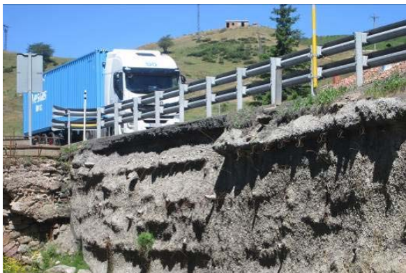
Figura 2. Degradación de muro de hormigón en masa por efecto de las sales fundentes y los ciclos de hielo/deshielo.
