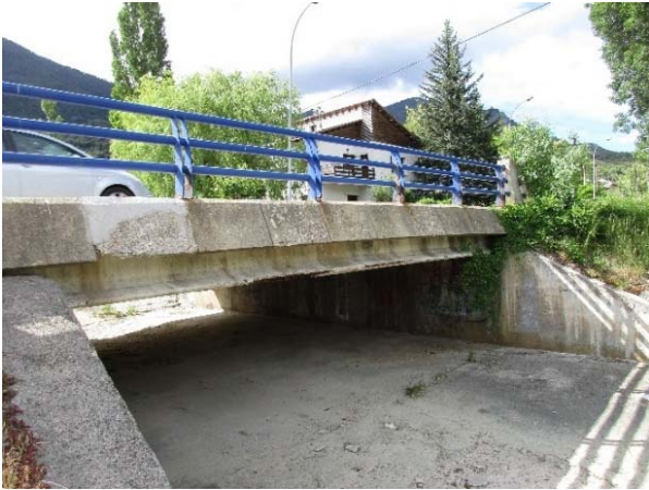
Figura 3. Obra de fábrica con daños severos por corrosión de armaduras por efecto de la circulación de aguas con sales fundentes.
