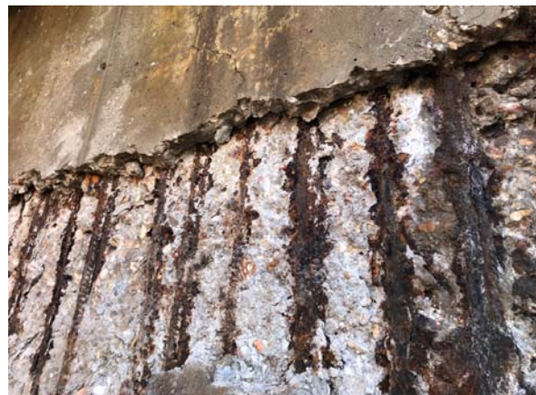
Figura 9. Detalle de estado de la armadura de estribo tras un mínimo picado del paramento de hormigón.
