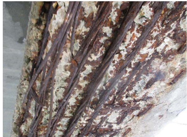
Figura 7. Detalle de estado del pretensado de la viga superior.
