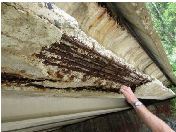
Figura 4. Grave afección al pretensado de las vigas laterales por afección directa de agua con fundentes sobre los paramentos de hormigón.
