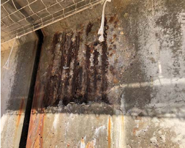
Figura 11. Detalle de degradación de alma por corrosión de armaduras.
