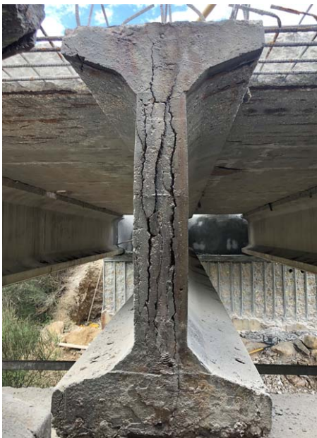
Figura 12. Detalle de degradación de hormigón de alma
