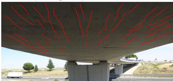
Figura 4. Fisuración longitudinal en losa de hormigón con reacciones expansivas.
