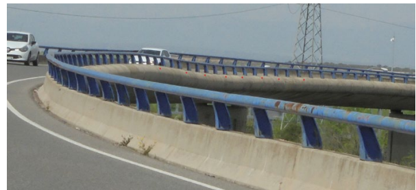
Figura 7. Flecha apreciable en centro de vano por pérdida de rigidez.
