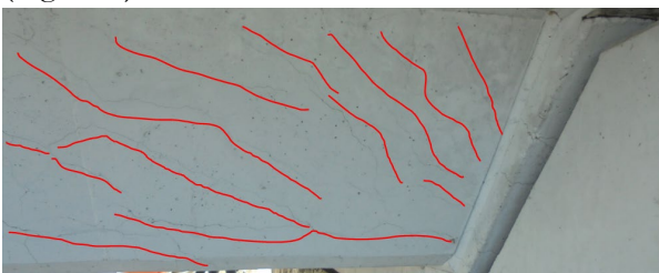
Figura 5. Fisuración oblicua en la losa cerca de la zona de apoyo en estribo.
