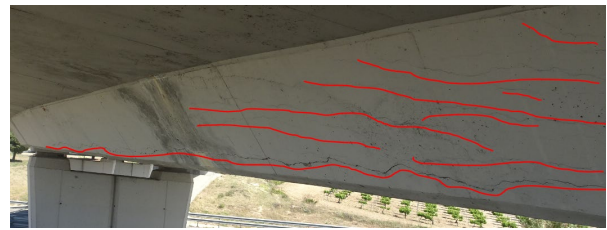
Figura 6. Fisuración en canto de la losa.
