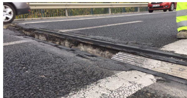
Figura 8. Detalle de la junta de calzada tras levantamiento de extremo del puente.
