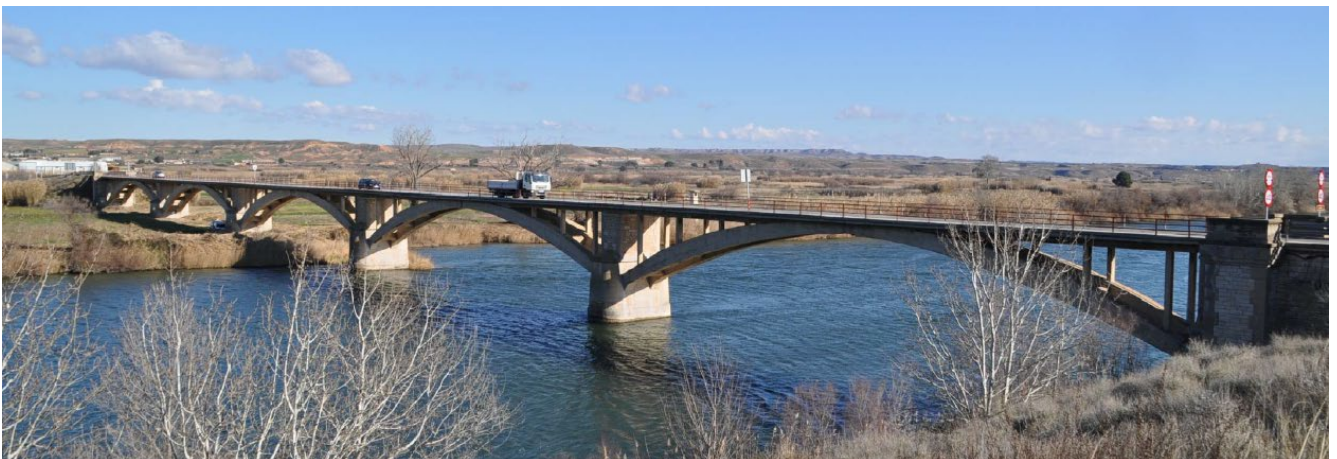
Figura 1. Puente de Gelsa sobre el Ebro. Estado inicial.
