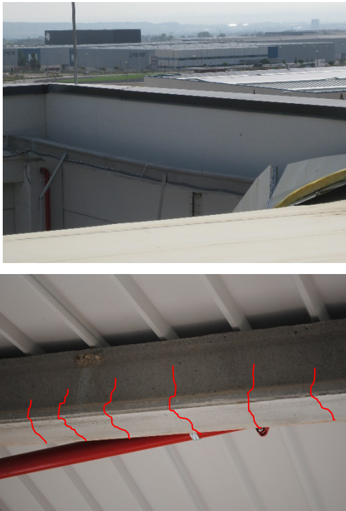
Figura 4. Vista de las correas adyacentes tras el colapso.
