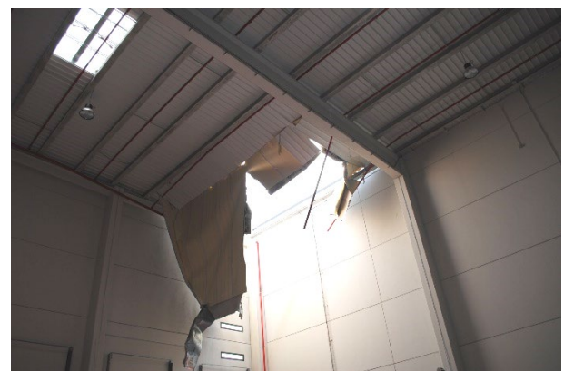
Figura 3. Zona del colapso.
