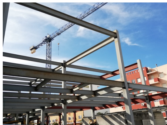
Figura 4. El Código Estructural modifica el contenido de la EN 1090, añadiendo requisitos adicionales a los de la norma armonizada, en contra de lo establecido por la Legislación Europea.
