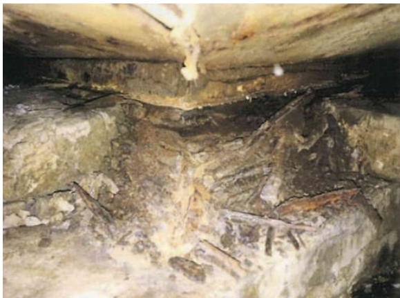
Figura 16. Estado apoyos estribos
