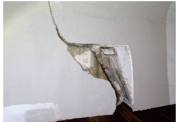
Figura 3. Deterioro en ménsula corta de junta izquierda de vano V-3 (tablero sur).
