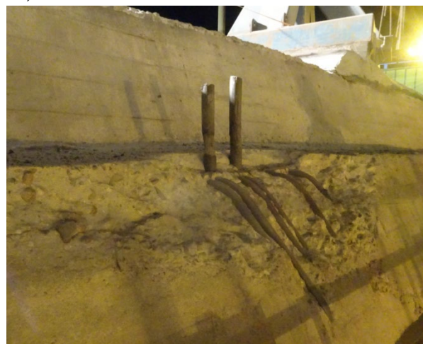
Figura 15. Pernos existentes en ménsula inferior lado Valencia (V-3).
