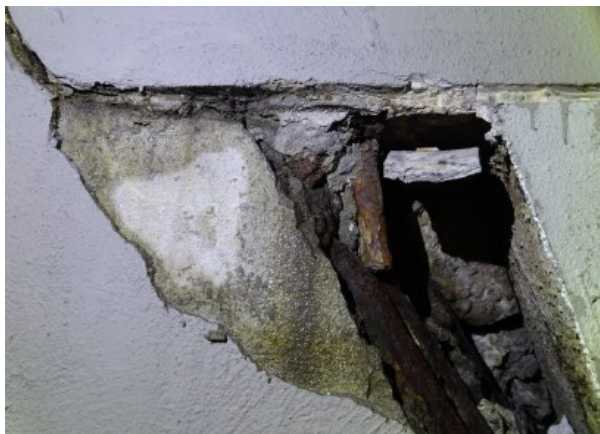
Figura 4. Detalle de pérdida de sección de hormigón y corrosión de armadura.
