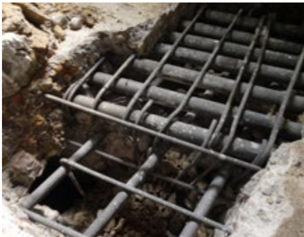
Figura 13. Armaduras descubiertas en cabeza de vigas mediante hidrodemolición.
