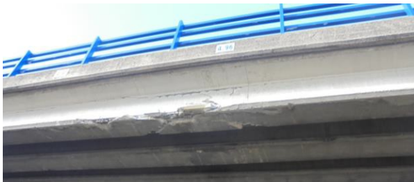
Figura 1. Impacto sobre viga.
