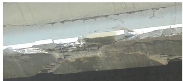
Figura 2. Daños provocados por el impacto cabeza inferior de la viga.
