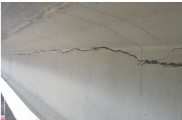
Figura 3. Detalle de rotura del alma.
