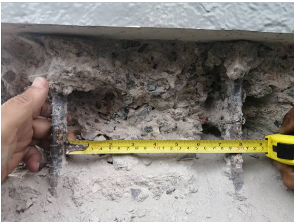
Figura 17. Roza en la pila del puente peatonal Porvenir. Diámetro y espaciado.
