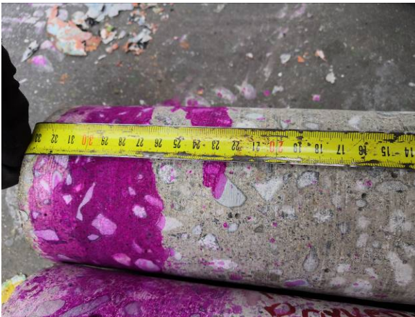
Figura 12. Profundidad de carbonatación en los testigos del puente peatonal Porvenir.
