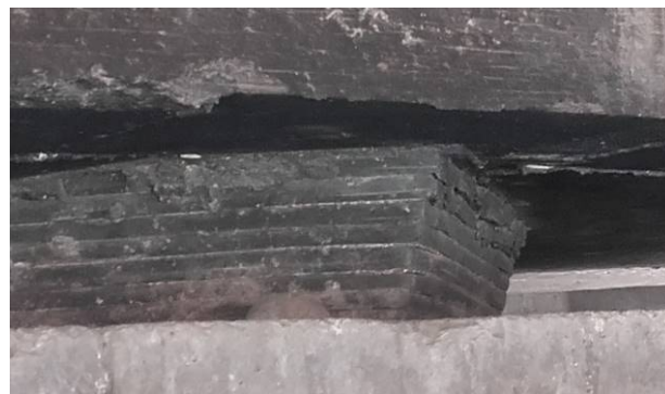
Figura 7. Aparatos de apoyo en la pila del puente vehicular Huáscar.
