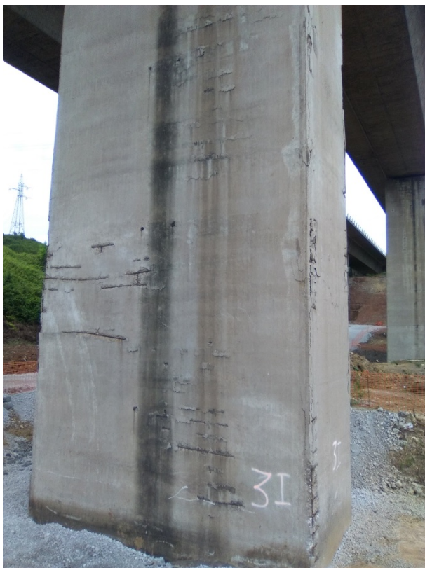
Figura 3. Detalle del deterioro en una pila
