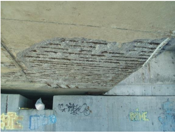
Figura 3. Zonas afectadas bajo tablero.
