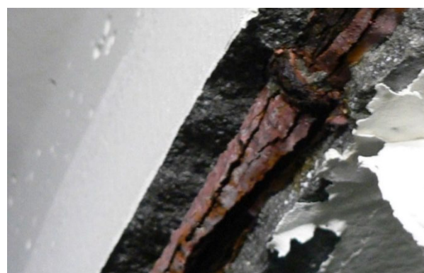
Figura 10. Estado de la capa de protección durante la inspección de 2017.
