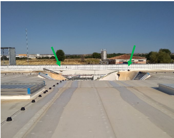
Figura 6. Vista de una de las cubiertas siniestradas (obsérvese que el hundimiento se produce entre dos puntos de desagüe).
