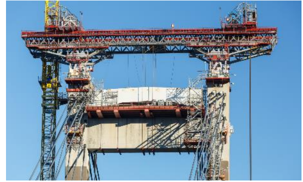
Figura 3.-Vista del pórtico de izado instalado para el izado del cabecero de ampliación de las torres del puente
