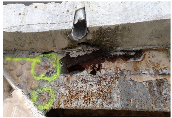
Figura 15. Pérdida total de sección en alma de cordón superior bajo un sumidero corto
