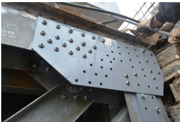
Figura 29. Nueva cartela en nudo superior de montante de apoyos
