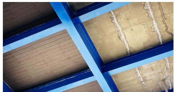
Figura 7. Refuerzo inferior ejecutado y sin ejecutar.
