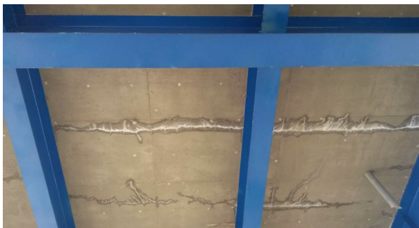
Figura 3. Fisura representativa en cara inferior.
