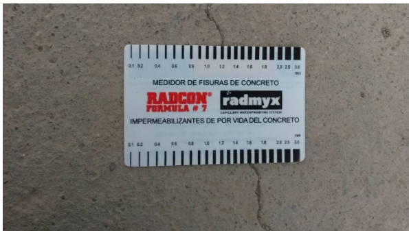
Figura 2. Fisura representativa en cara superior.
