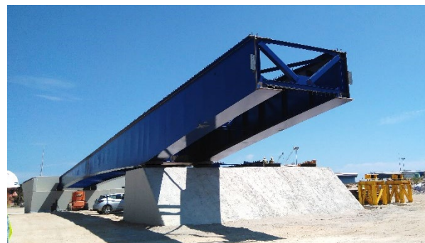
Figura 10. Mota de protección en pila P-3.
