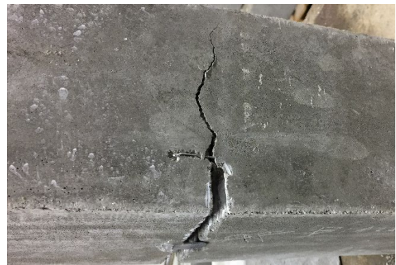
Figura 5. Grieta tras el ensayo a tracción por flexión.
